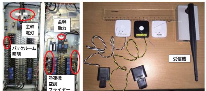
分電盤内に設置された電流センサ
